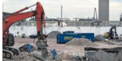
Platz für den Neubau: Zurzeit laufen am Neusser Hafen die Abbrucharbeiten des alten Gebäudes.
